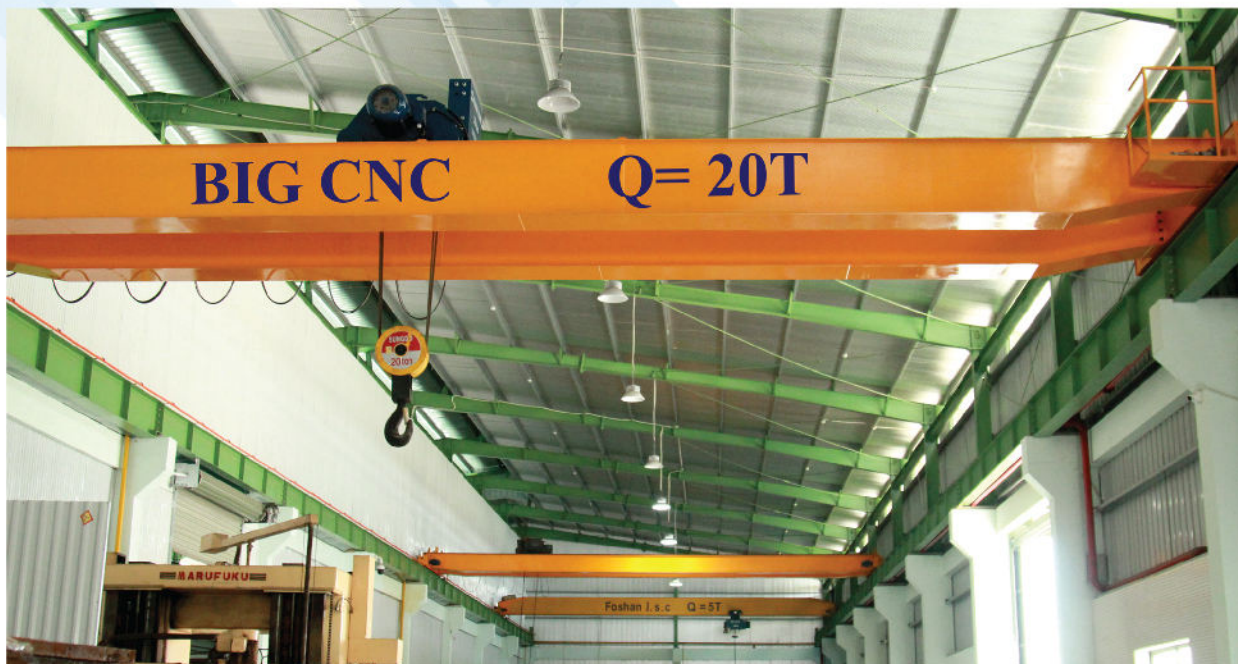
CẦU TRỤC TRỌNG TẢI 5 TẤN/ 5 TONS OVERHEAD CRANE - QUANTITY: 04 CẦU TRỤC TRỌNG TẢI 20 TẤN/ 20 TONS OVERHEAD CRANE - QUANTITY: 01
